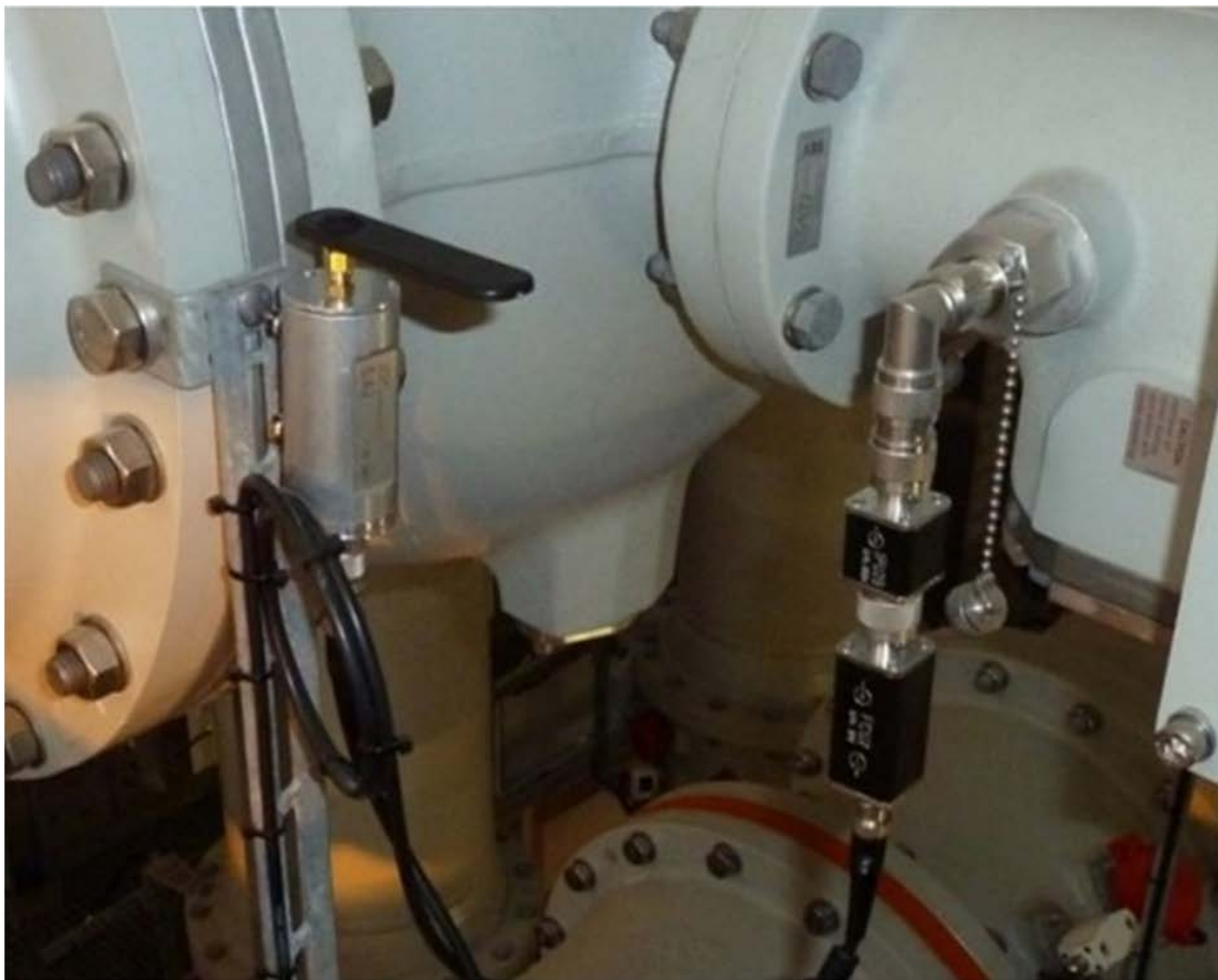
Obr.16 Příklad instalace „gating“ antény poblíž jednotky předzpracování signálu
